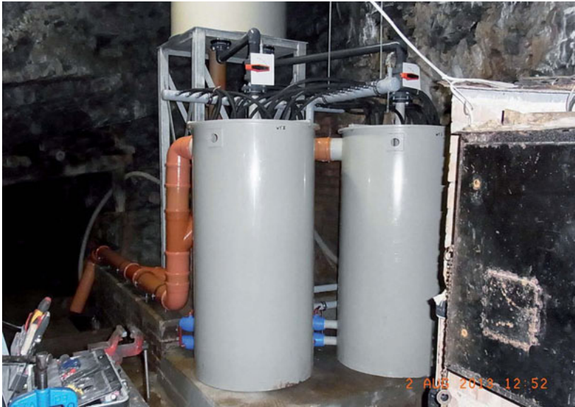
Abb. 5: Untertägige Wärmetauscheranlage im Röhrichtschacht Wettelrode
