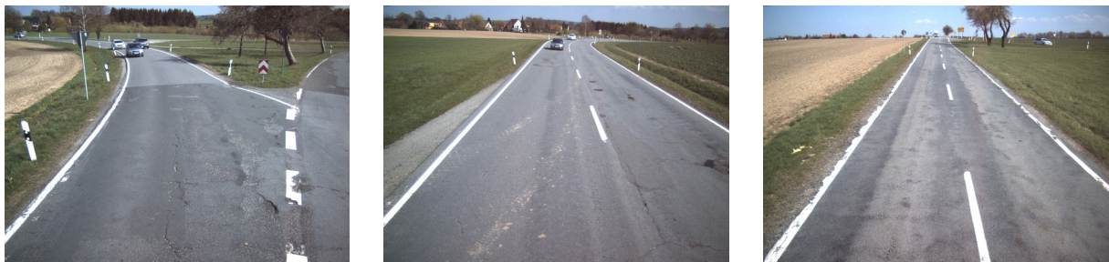
Bild 1, 2, 3 (von links nach rechts): Straßenschäden der S161 im Bestand
