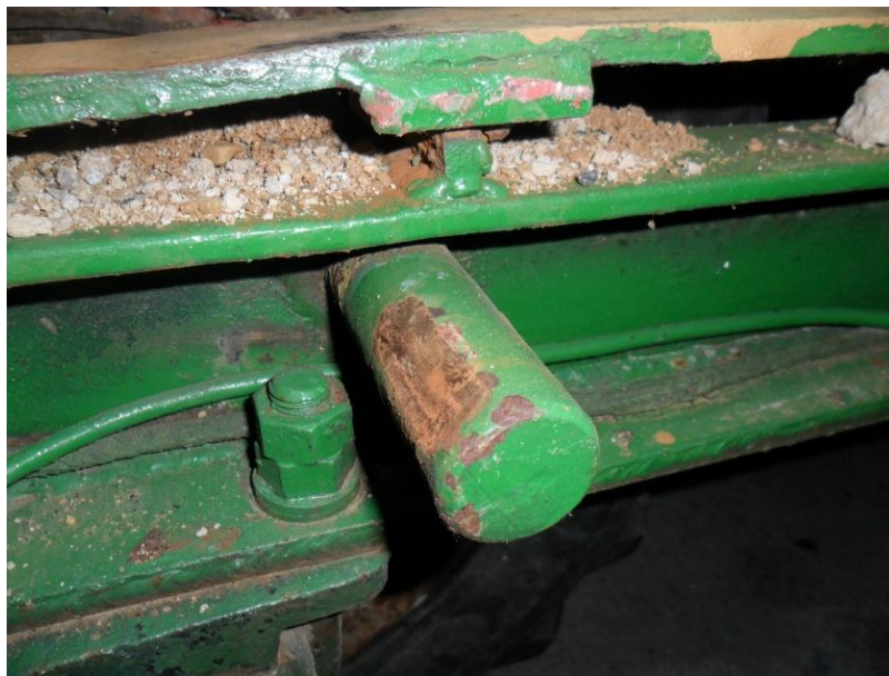
Bild 20: Verschleißspuren Bolzen (K2)
